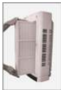
Installazione filtro ULPA (ill. 3)
