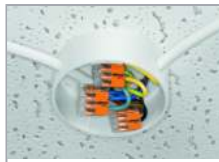
Verdeling van verlichtingssystemen in centraaldozen
