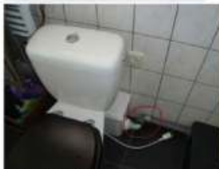
FOUT Foute aansluiting 2 x 90 graden bocht gebruikt. Dit bouwt weerstand op en zorgt voor verstopping. Het moet na gebruik defect raken.
