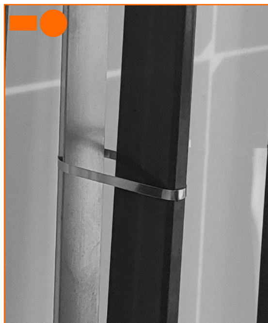
Beugel borging aan balkonreling onderzijde
