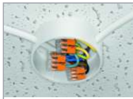
Verdeling van verlichtingssystemen in centraaldozen
